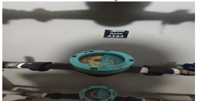
Contador de Agua
