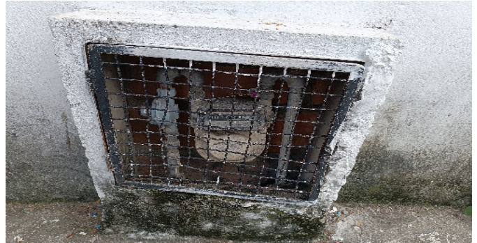
Contador de Gas
