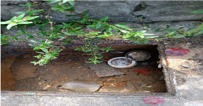
Contador de Agua
