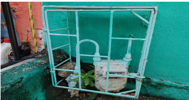
Contador de Gas
