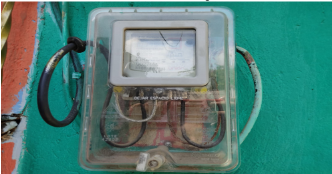
Contador de Energia
