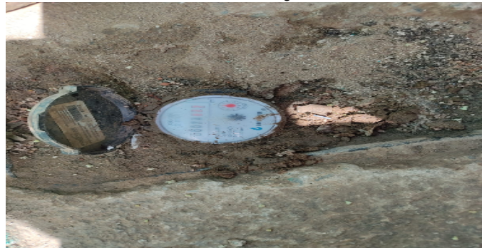
Contador de Agua
