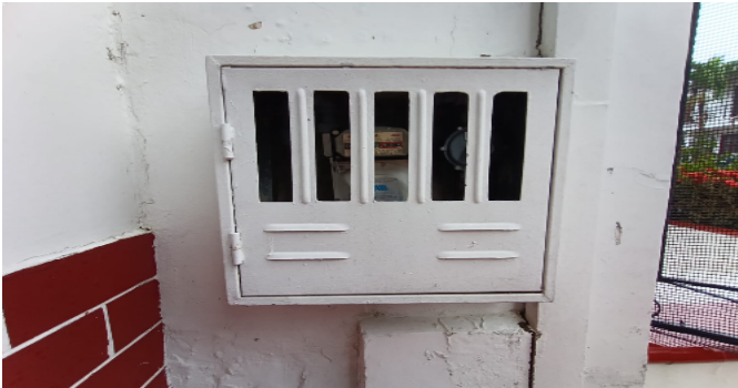
Contador de Gas
