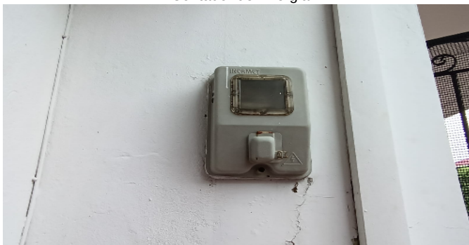
Contador de Energia
