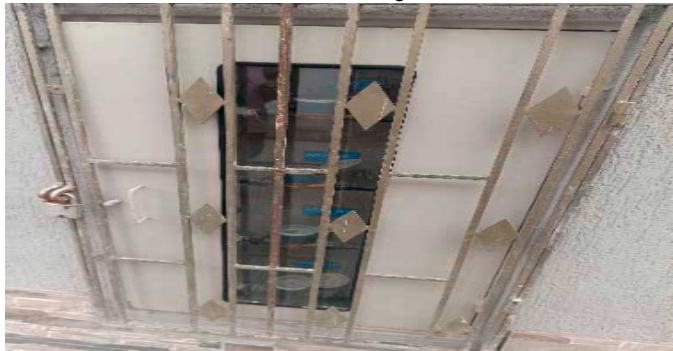
Contador de Agua
