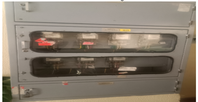
Contador de Energia
