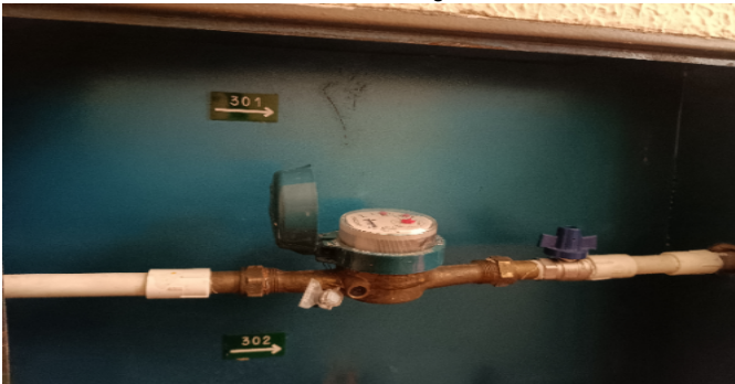
Contador de Agua
