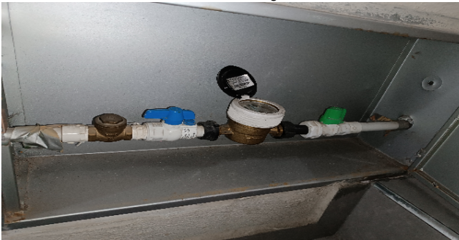
Contador de Agua
