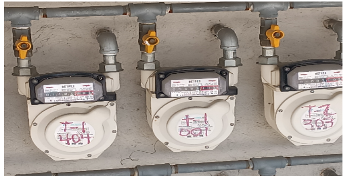
Contador de Gas
