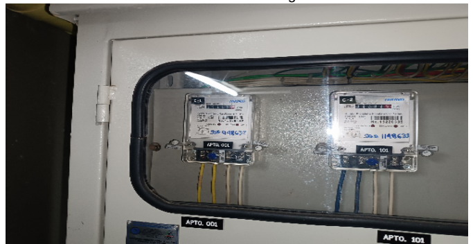
Contador de Energia
