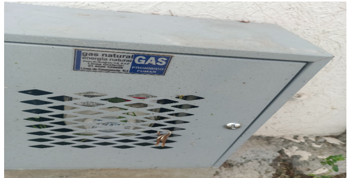
Contador de Gas
