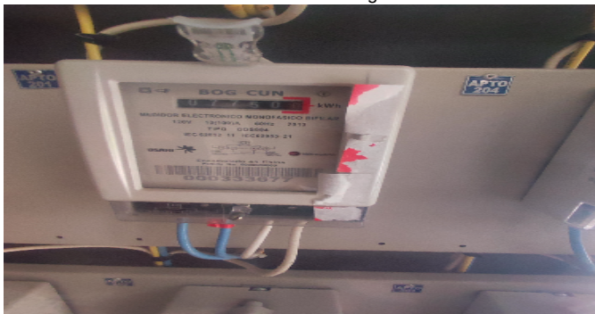
Contador de Energia
