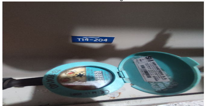
Contador de Agua
