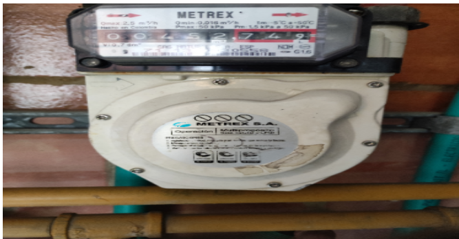
Contador de Gas
