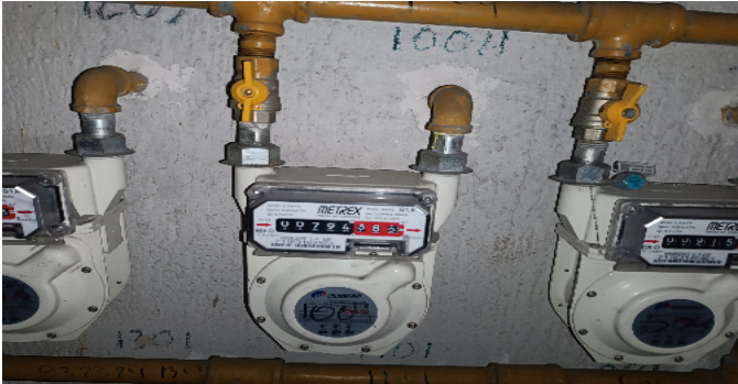
Contador de Gas
