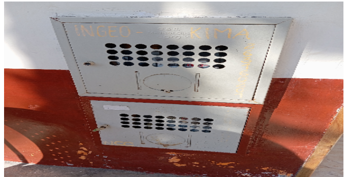
Contador de Gas
