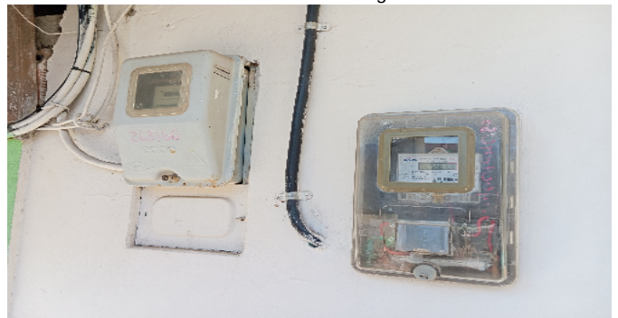
Contador de Energia
