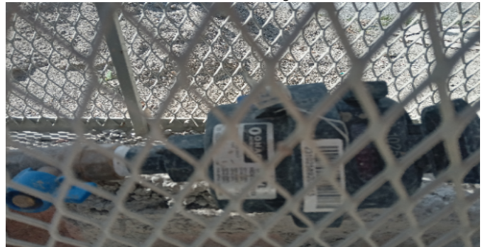
Contador de Agua
