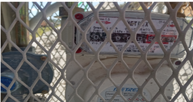
Contador de Gas
