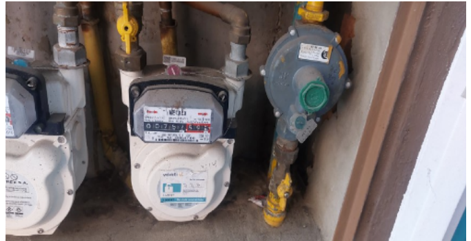
Contador de Gas
