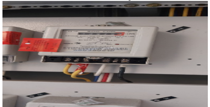
Contador de Energia
