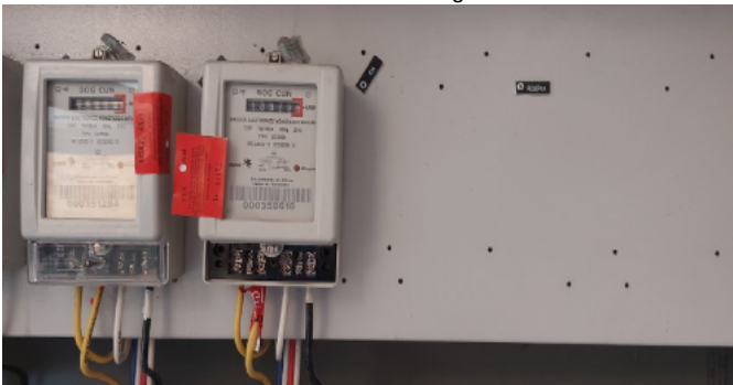
Contador de Energia
