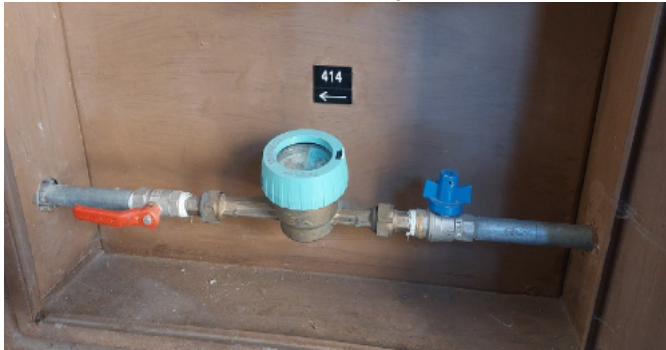
Contador de Agua
