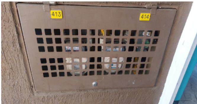
Contador de Gas
