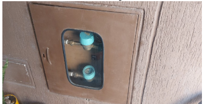
Contador de Agua
