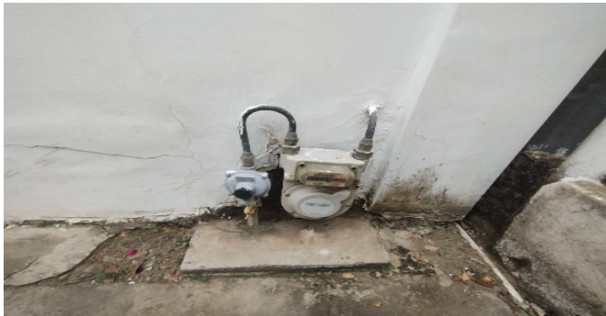
Contador de Gas
