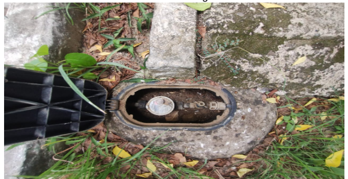
Contador de Agua
