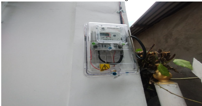
Contador de Energia
