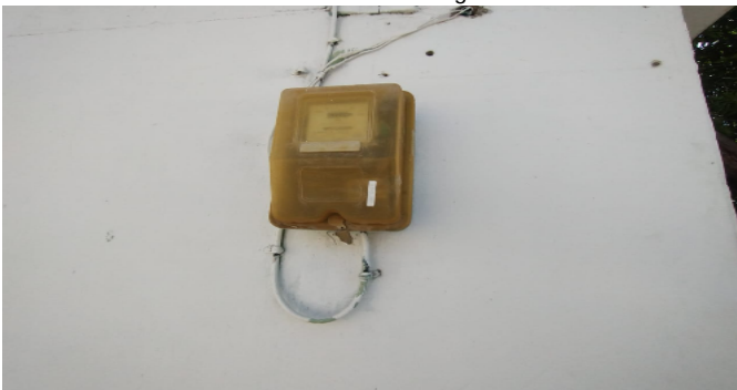
Contador de Energia
