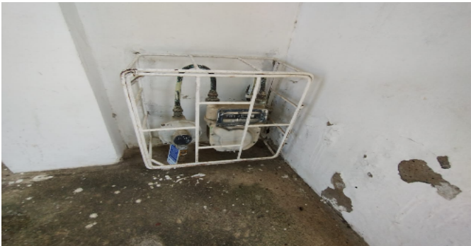
Contador de Gas
