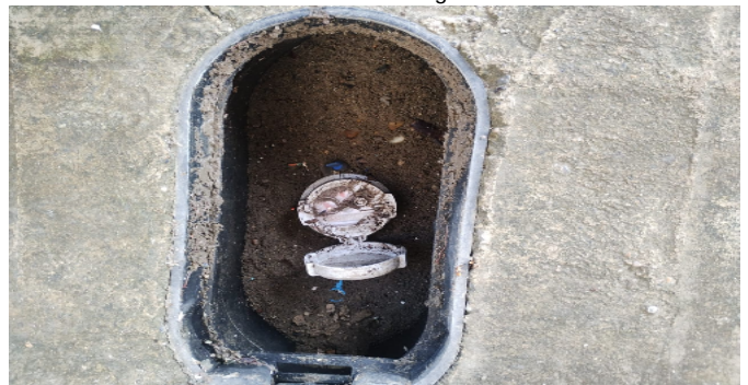
Contador de Agua
