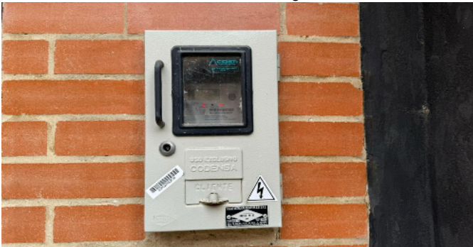
Contador de Energia
