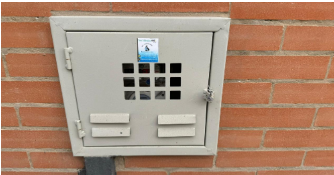
Contador de Gas
