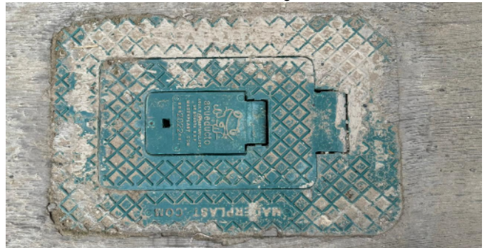
Contador de Agua
