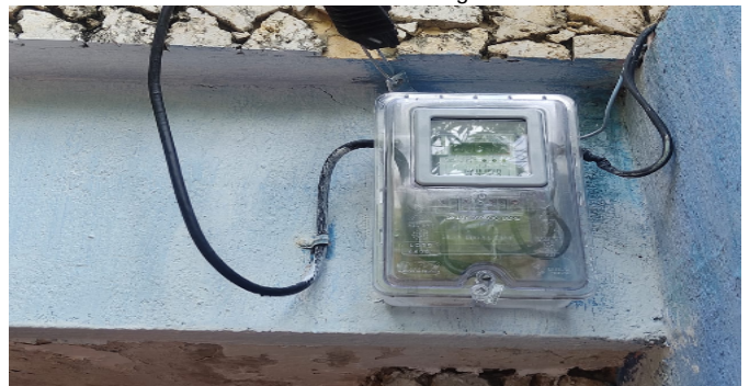
Contador de Energia
