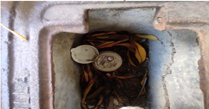
Contador de Agua
