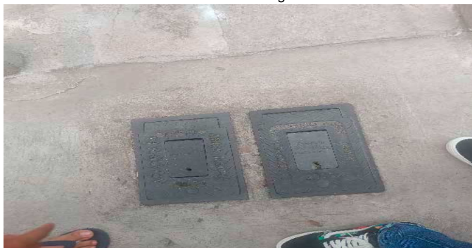
Contador de Agua
