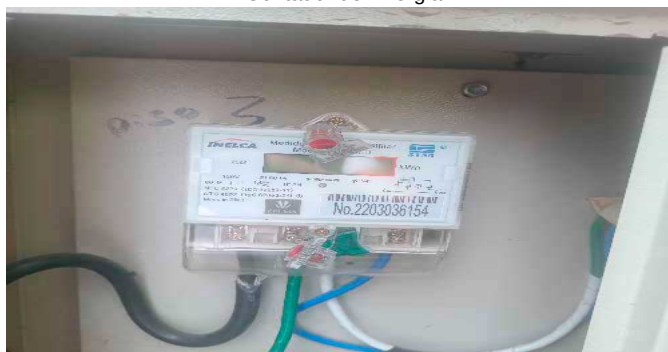
Contador de Energia
