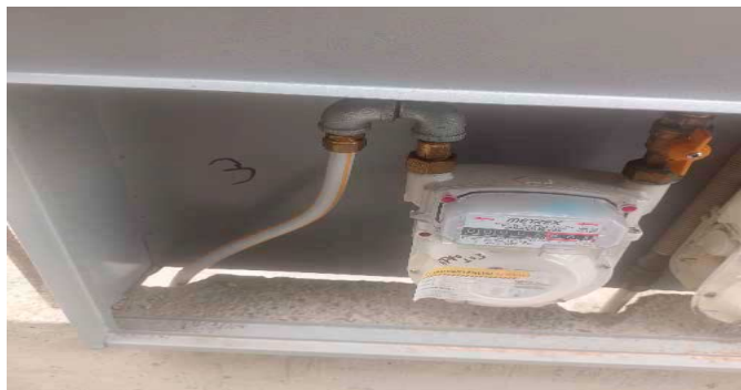
Contador de Gas
