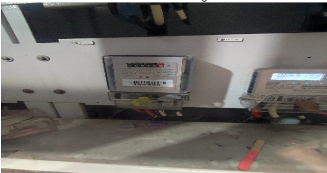
Contador de Energia
