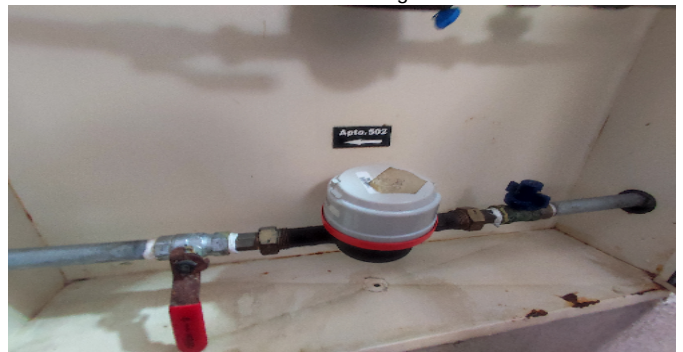
Contador de Agua
