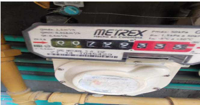
Contador de Gas
