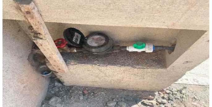
Contador de Agua
