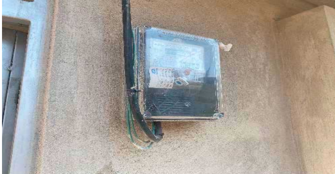
Contador de Energia
