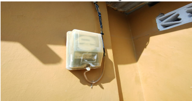
Contador de Energia
