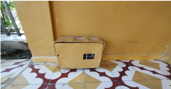
Contador de Gas
