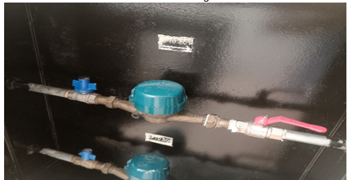
Contador de Agua
