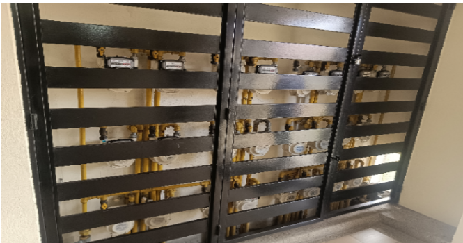
Contador de Gas
