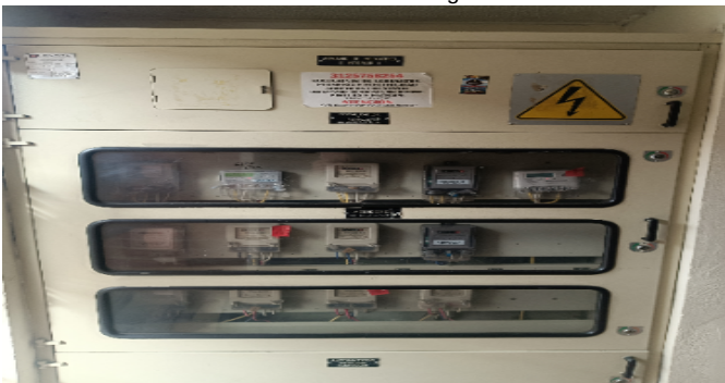
Contador de Energia
