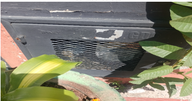
Contador de Gas
