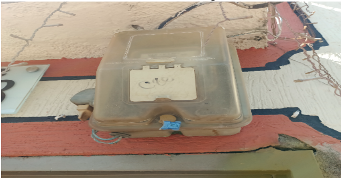
Contador de Energia
