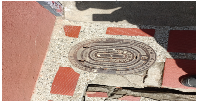
Contador de Agua
