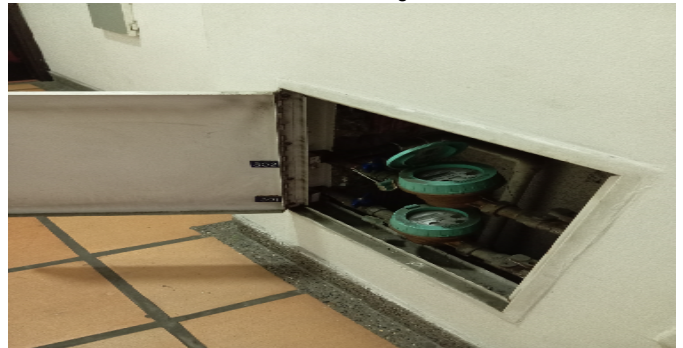
Contador de Agua
