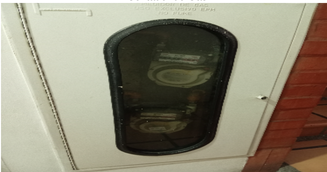
Contador de Gas
