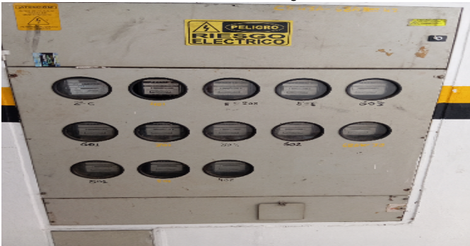
Contador de Energia
