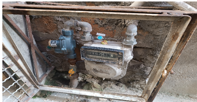
Contador de Gas
