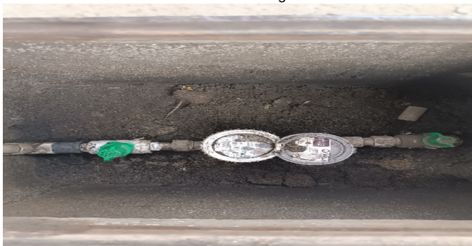
Contador de Agua
