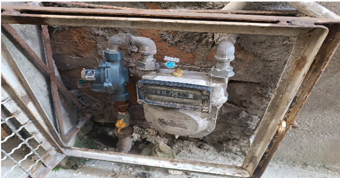
Contador de Gas
