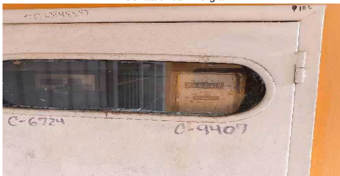
Contador de Energia
