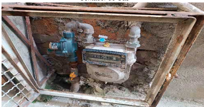
Contador de Gas
