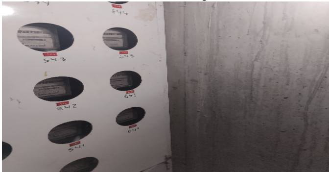
Contador de Energia
