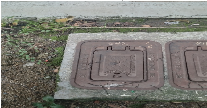
Contador de Agua
