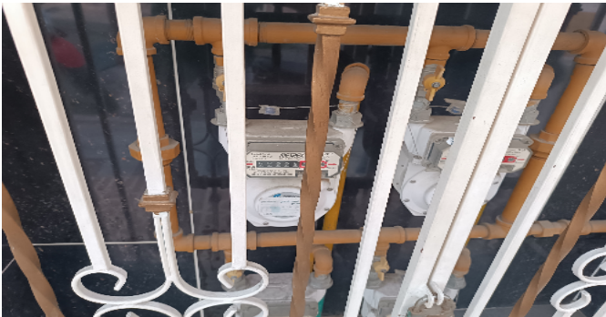
Contador de Gas
