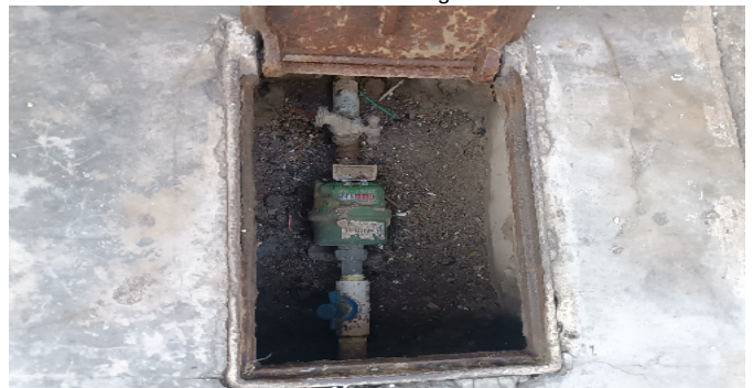
Contador de Agua
