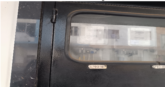
Contador de Energia
