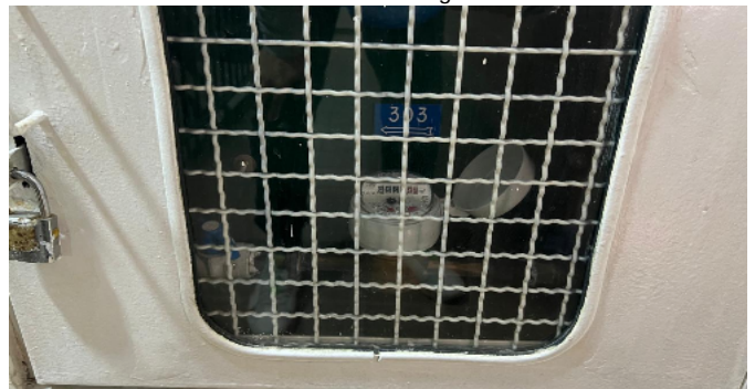
Contador de Agua
