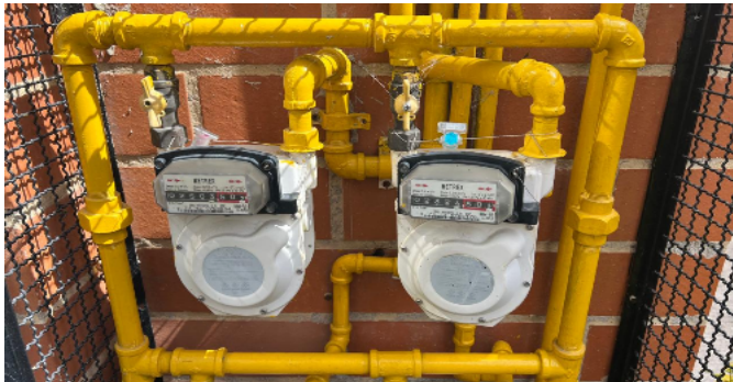
Contador de Gas
