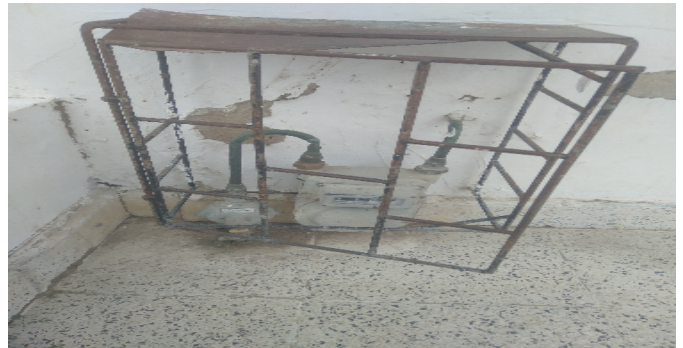
Contador de Gas
