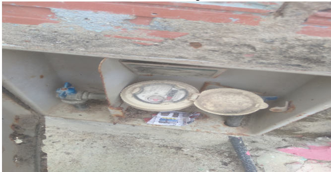
Contador de Agua
