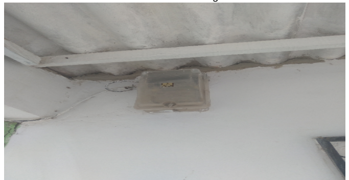
Contador de Energia
