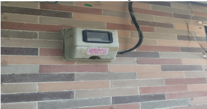
Contador de Energia
