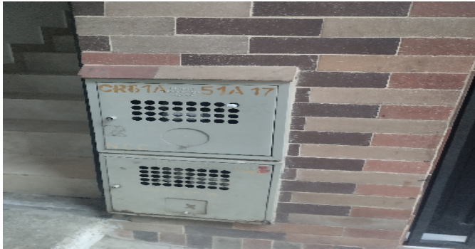
Contador de Gas
