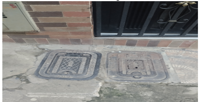
Contador de Agua
