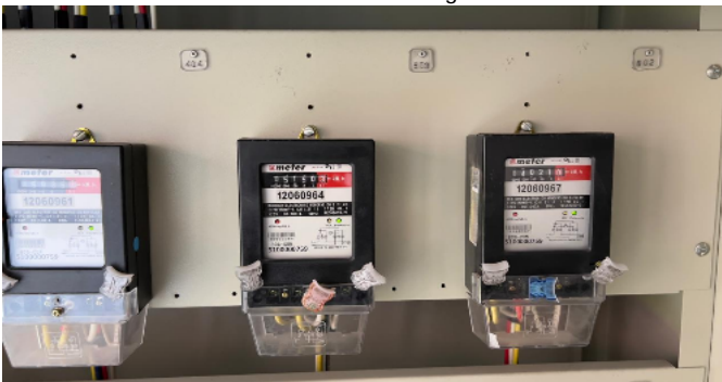
Contador de Energia
