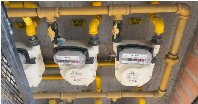
Contador de Gas
