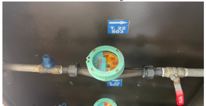
Contador de Agua
