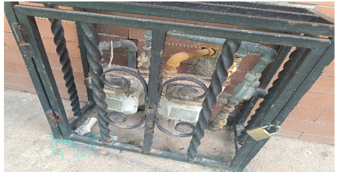
Contador de Gas
