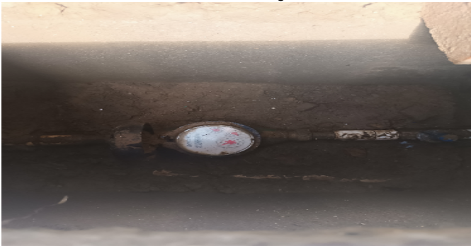
Contador de Agua
