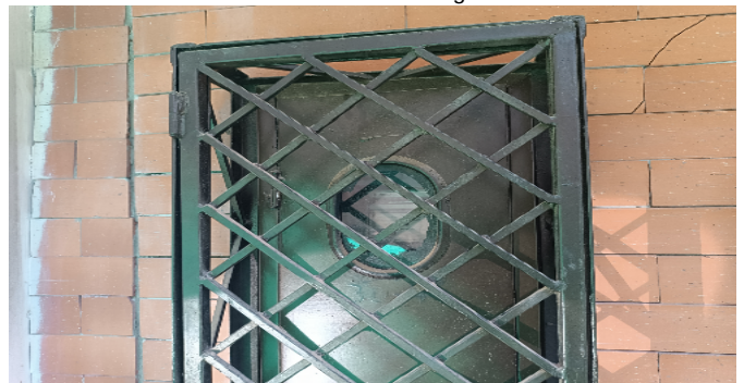
Contador de Energia
