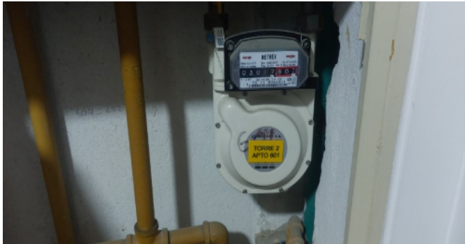
Contador de Gas
