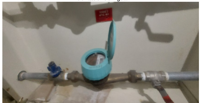
Contador de Agua
