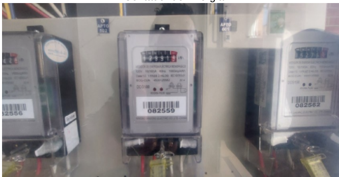
Contador de Energia
