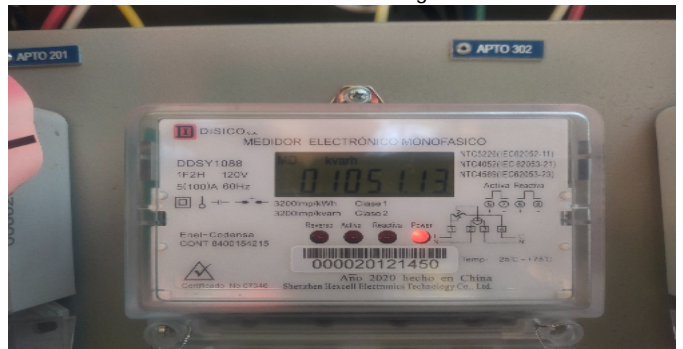
Contador de Energia
