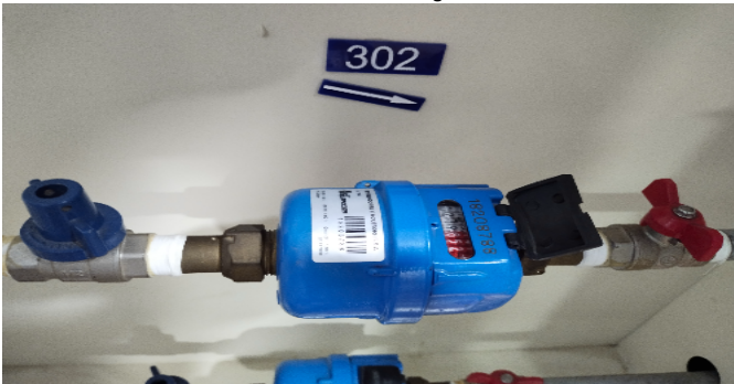
Contador de Agua
