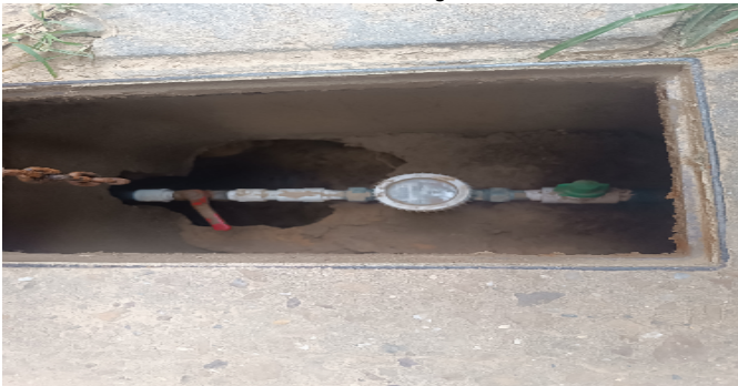
Contador de Agua
