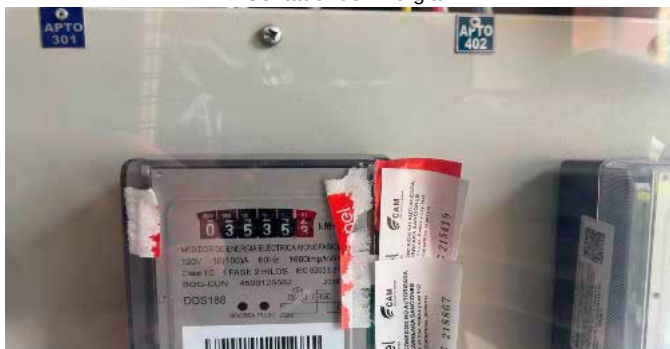
Contador de Energia
