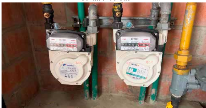
Contador de Gas
