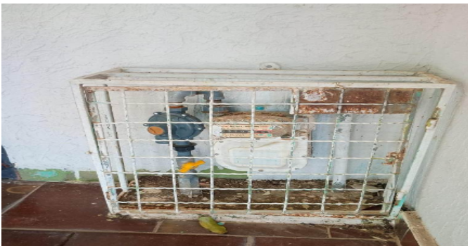
Contador de Gas
