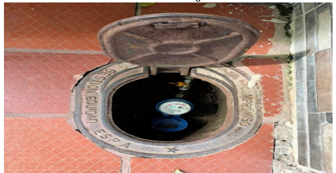
Contador de Agua
