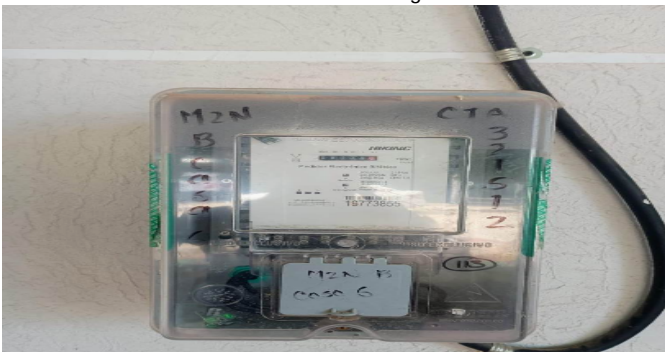
Contador de Energia
