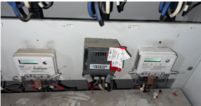
Contador de Energia
