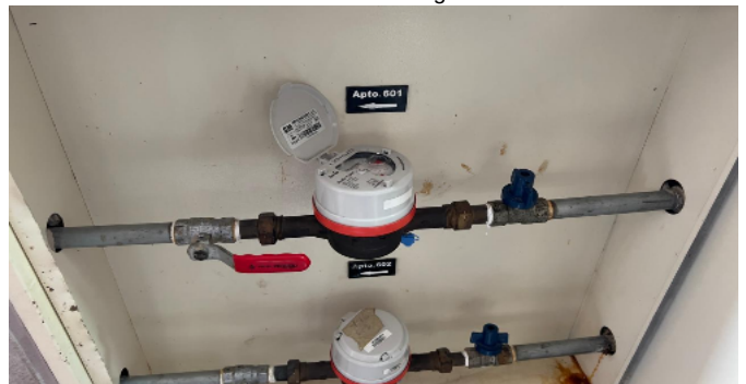
Contador de Agua
