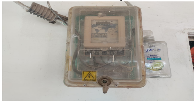
Contador de Energia
