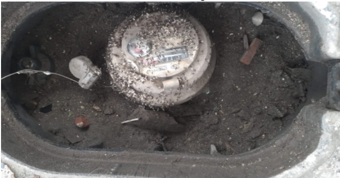
Contador de Agua
