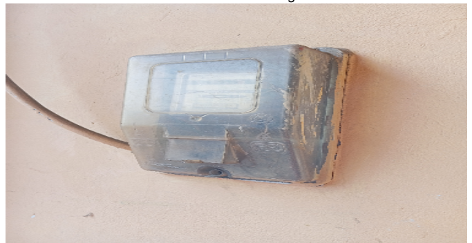
Contador de Energia
