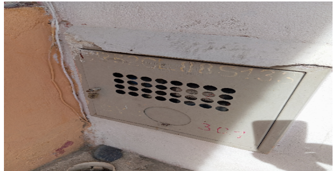
Contador de Gas
