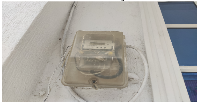
Contador de Energia
