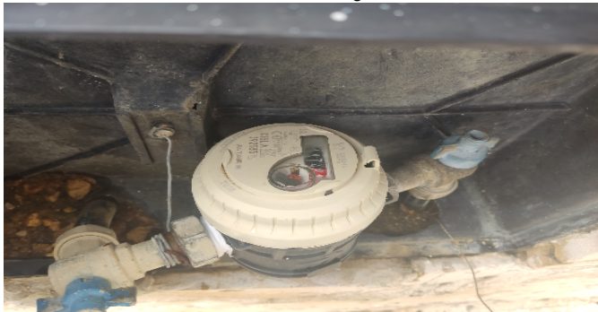
Contador de Agua
