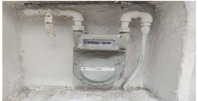
Contador de Gas
