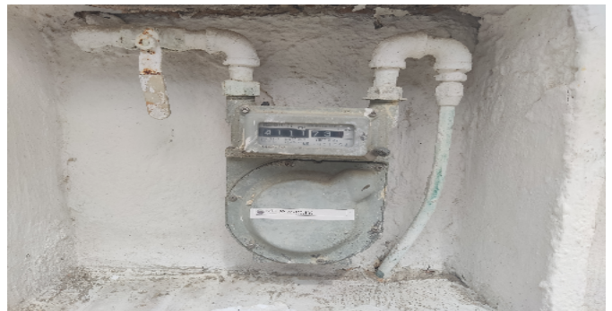
Contador de Gas
