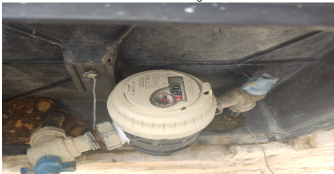
Contador de Agua
