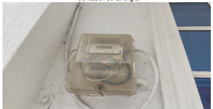
Contador de Energia
