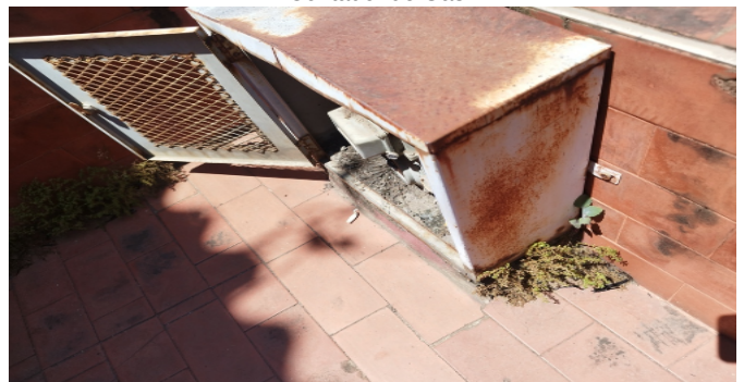
Contador de Gas
