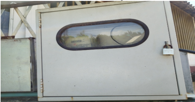
Contador de Energia
