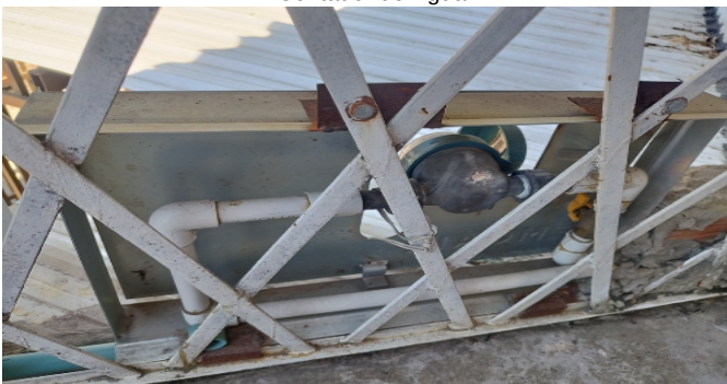
Contador de Agua
