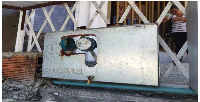
Contador de Agua
