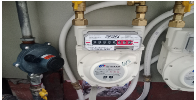
Contador de Gas
