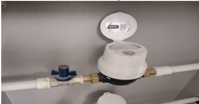
Contador de Agua
