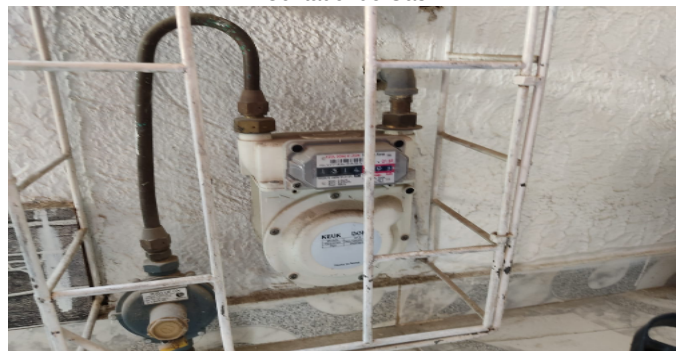
Contador de Gas
