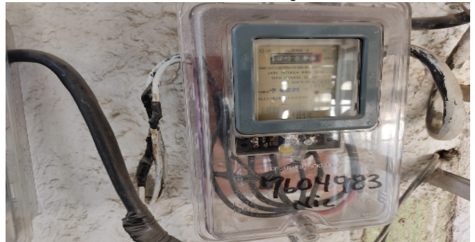
Contador de Energia
