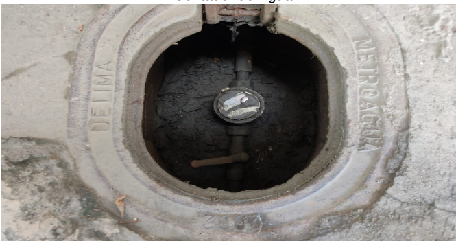
Contador de Agua
