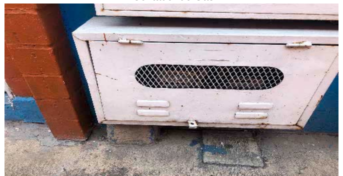
Contador de Gas
