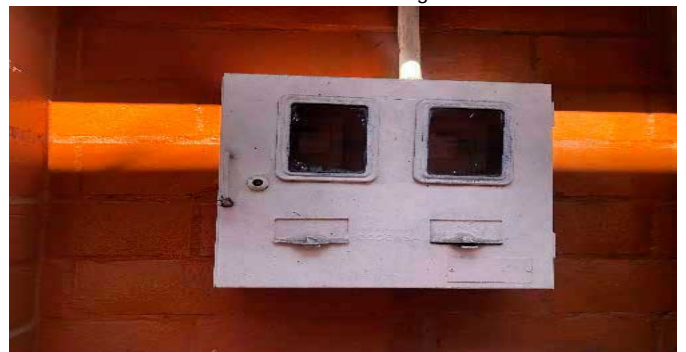
Contador de Energia
