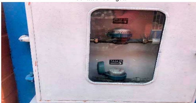
Contador de Agua
