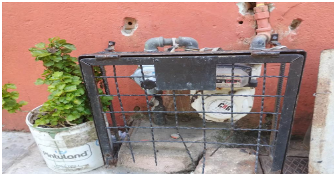
Contador de Gas
