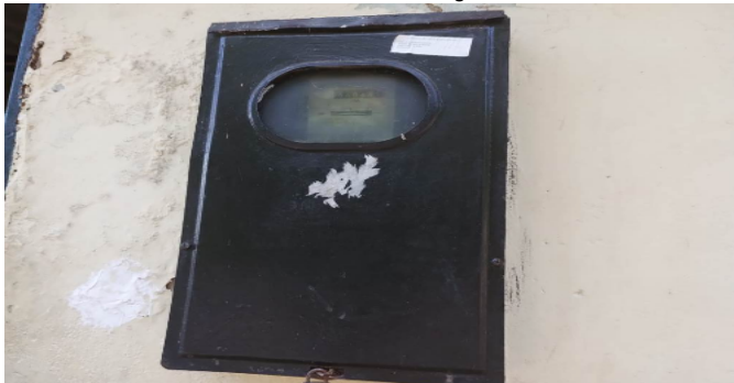
Contador de Energia
