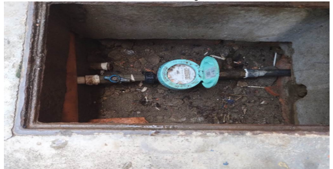
Contador de Agua
