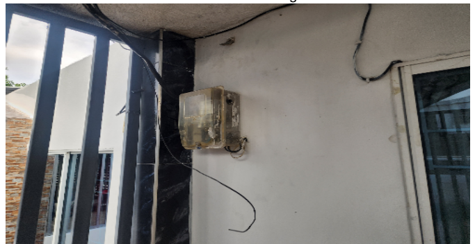
Contador de Energia
