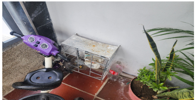
Contador de Gas
